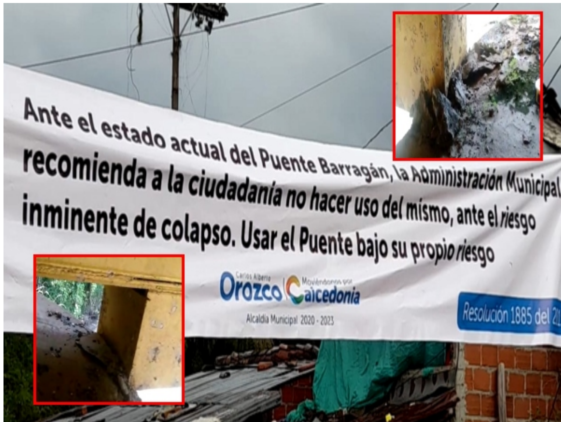
«Al riesgo del colapso»: Se trata del puente Barragán que conecta al Caicedonia con el Quindío.
