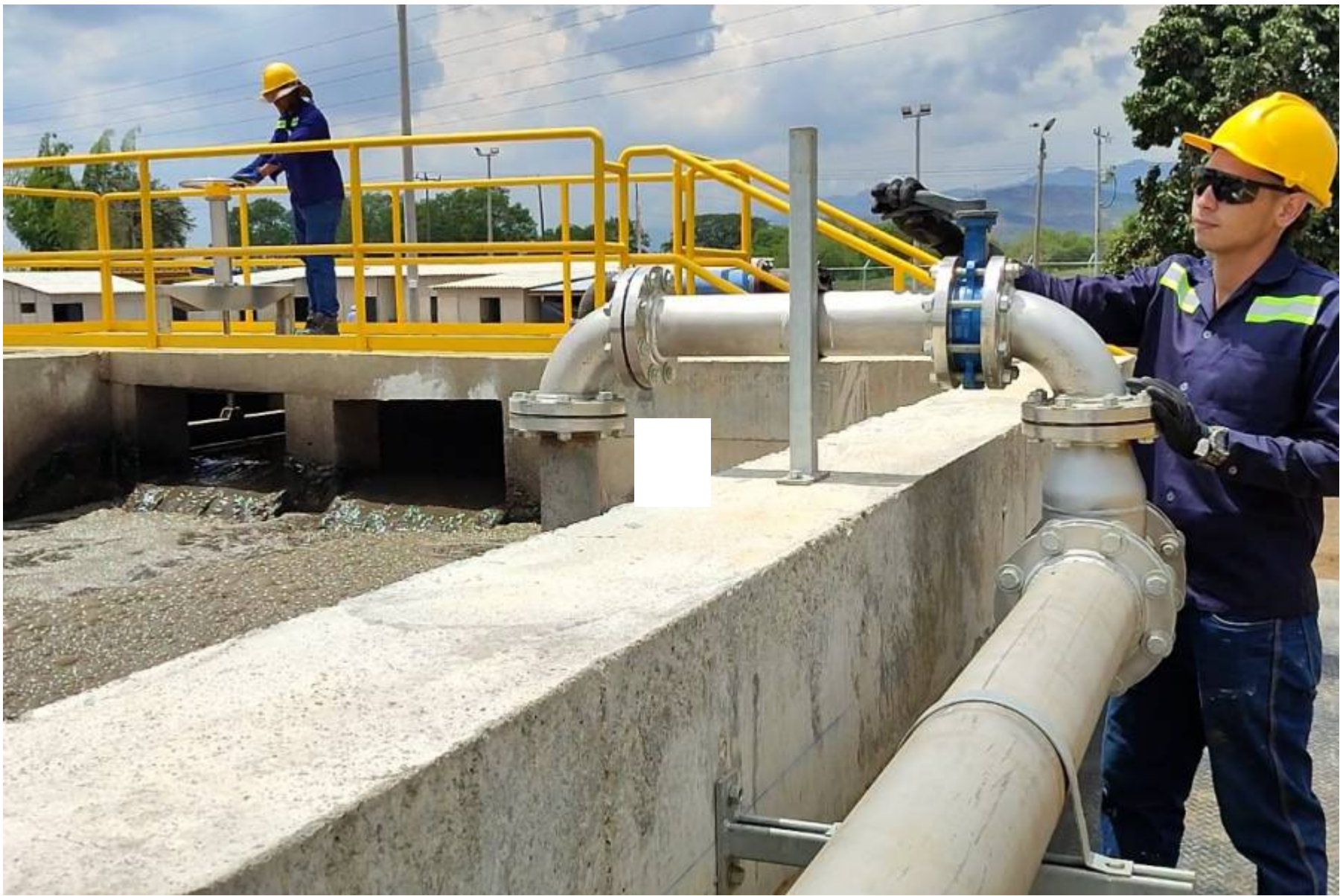
La Ptar (Planta de Tratamiento de Aguas Residuales), que tendrá el objetivo de frenar la contaminación del río Cauca Foto: El País
