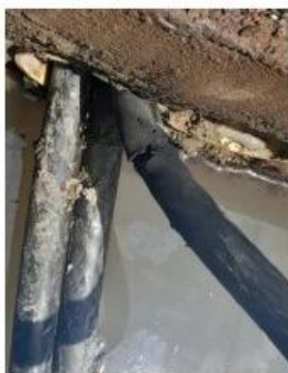
Así quedó el cableado afectado por el hurto.
