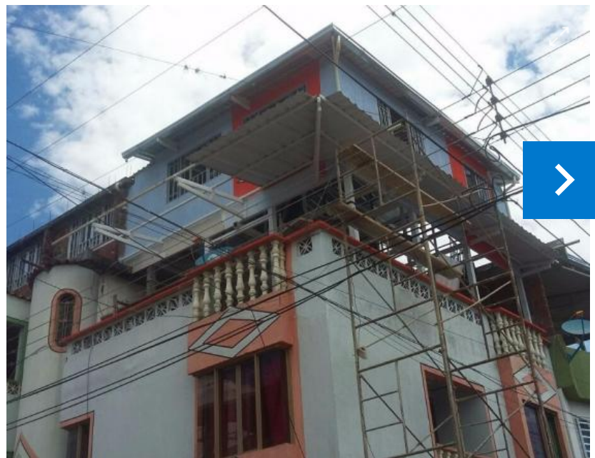
En este andamio estaba parado el hombre cuando recibió la descarga eléctrica y cayó al vacío. Foto: cortesía para El País
