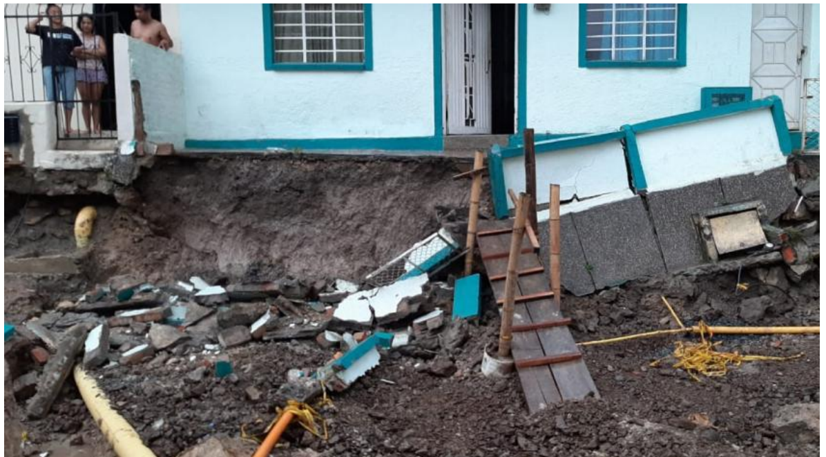
Deslizamiento en sector de Belén en Cali
