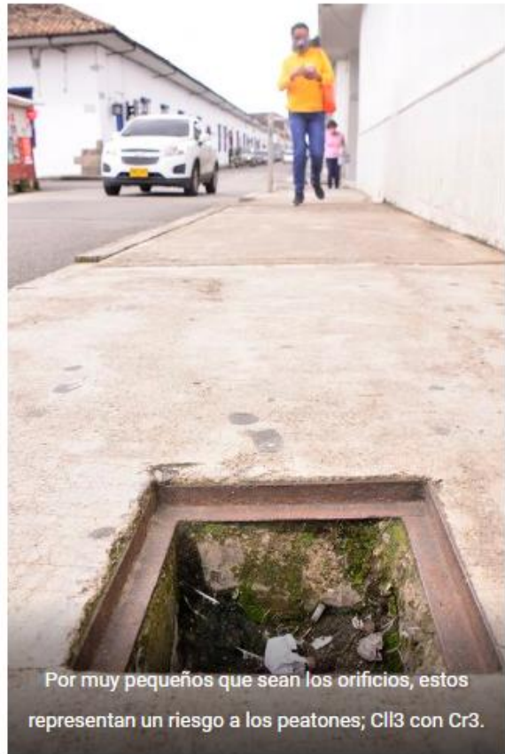
Gustavo Iván Salazar es un invidente que ha tenido accidentes por el deterioro y mal estado de las tapas de las cajas del centro de la ciudad, para colmo de males en esta escena se encontró también con un orificio en el andén; CII5 con Cr3.
