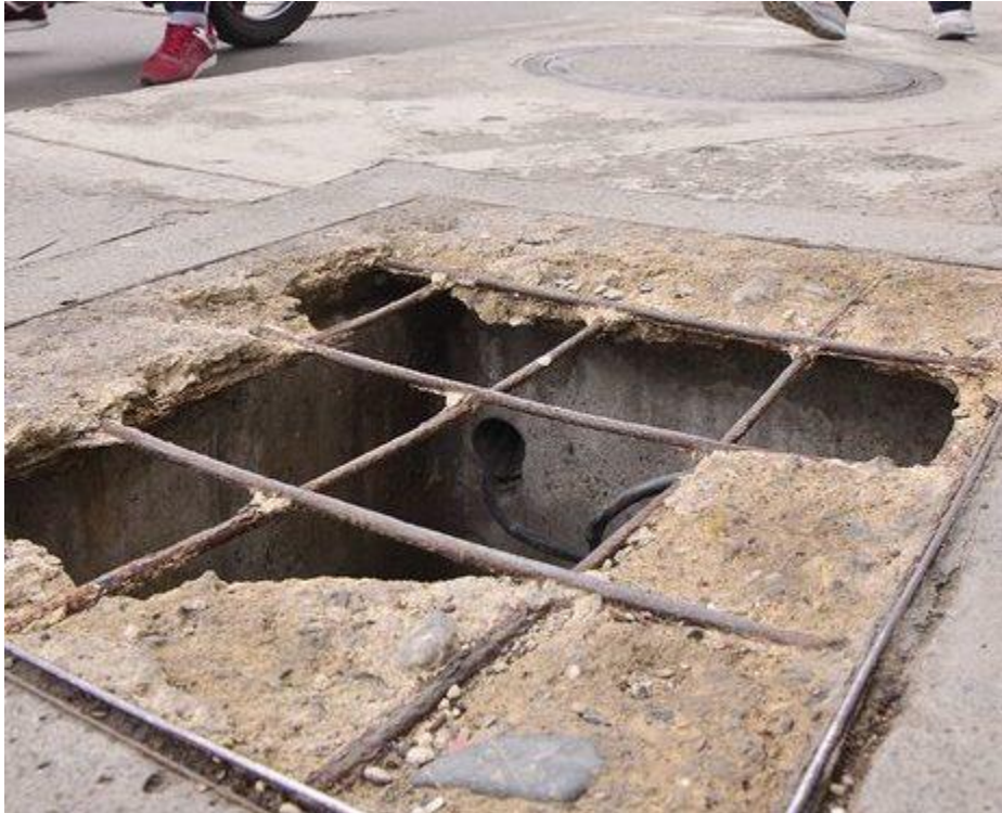
El deterioro de las tapas deja ver el cableado en las cajas; Cll7 con Cr 6.
