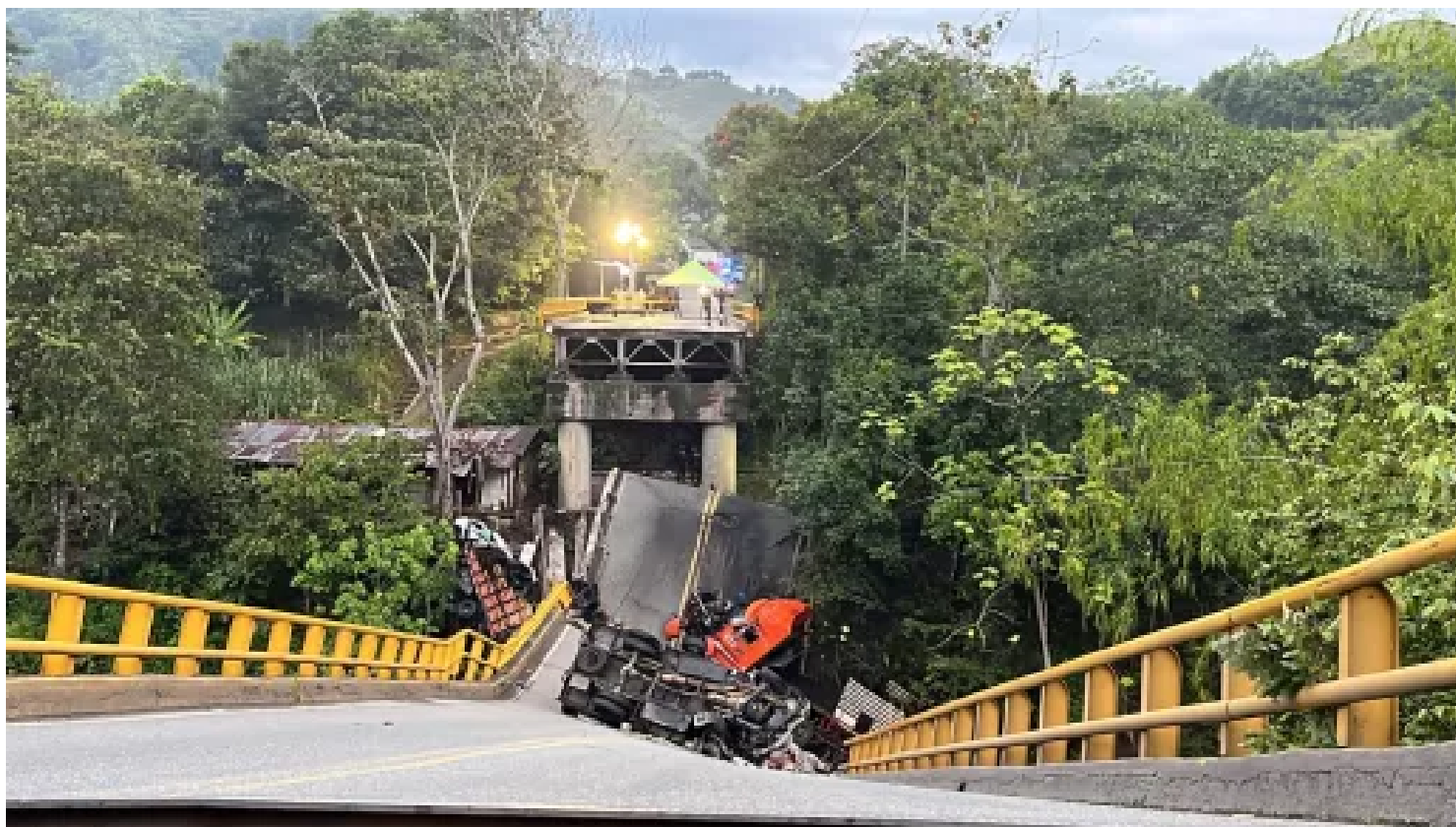
Colapso de puente en río La Vieja. Foto: Blu Radio.
