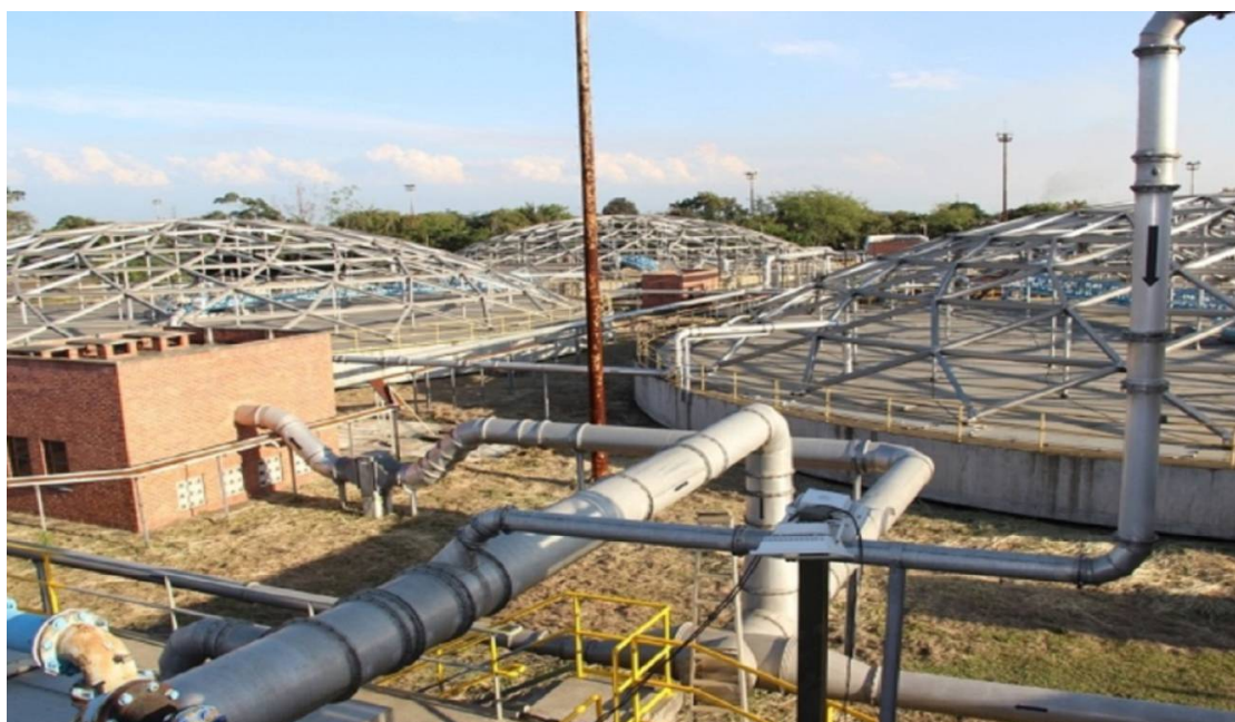
PTAR Cañaveralejo / Concejo Municipal de Santiago de Cali
