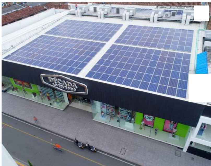
En los techos de este establecimiento comercial en Tuluá se encuentran instalados los módulos y paneles que captan la energía solar que luego se utiliza en iluminación de oficinas, vitrinas y bodegas. Cortesía para El País
