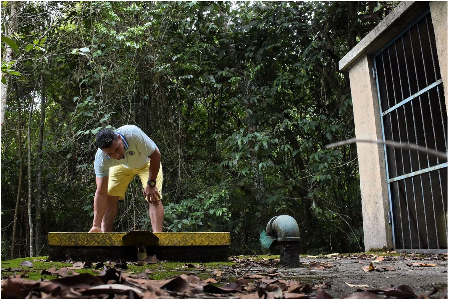
Habitantes de El Saladito han manifestado que el acueducto de ellos fue construido hace más de 50 años y que no ha tenido ningún tipo de mantenimiento. | Foto: Aymer Andrés Álvarez
