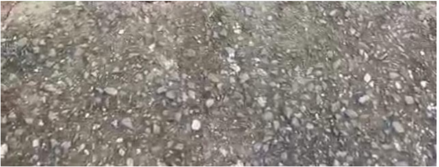
Este es el puente en mal estado de la Calle 72z2 # 28D - 32, en Poblado 2. | Foto: Cortesía de la comunidad.
