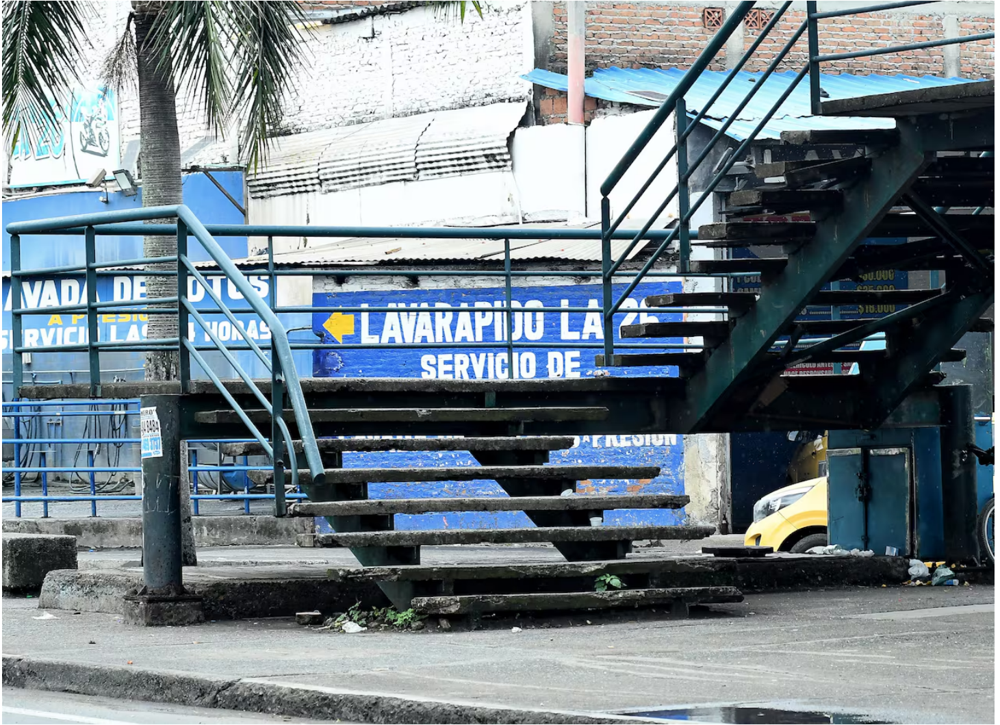
En la Calle 25 con Carrera 15 hay un puente peatonal con notables fallas. | Foto: WIRMAN RÍOS
