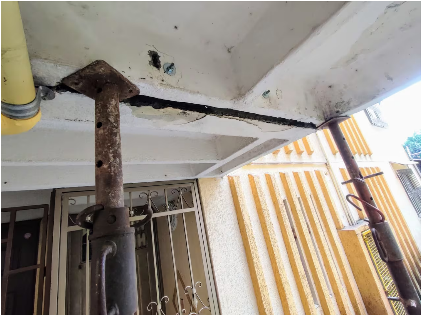
Evacuan varias torres de apartamentos en el sector de Chiminangos en Cali por fallas estructurales. | Foto: José Luis Guzmán/El País
