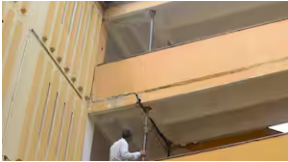
Habitantes de Chiminangos temen que las demás torres puedan estar en riesgo
