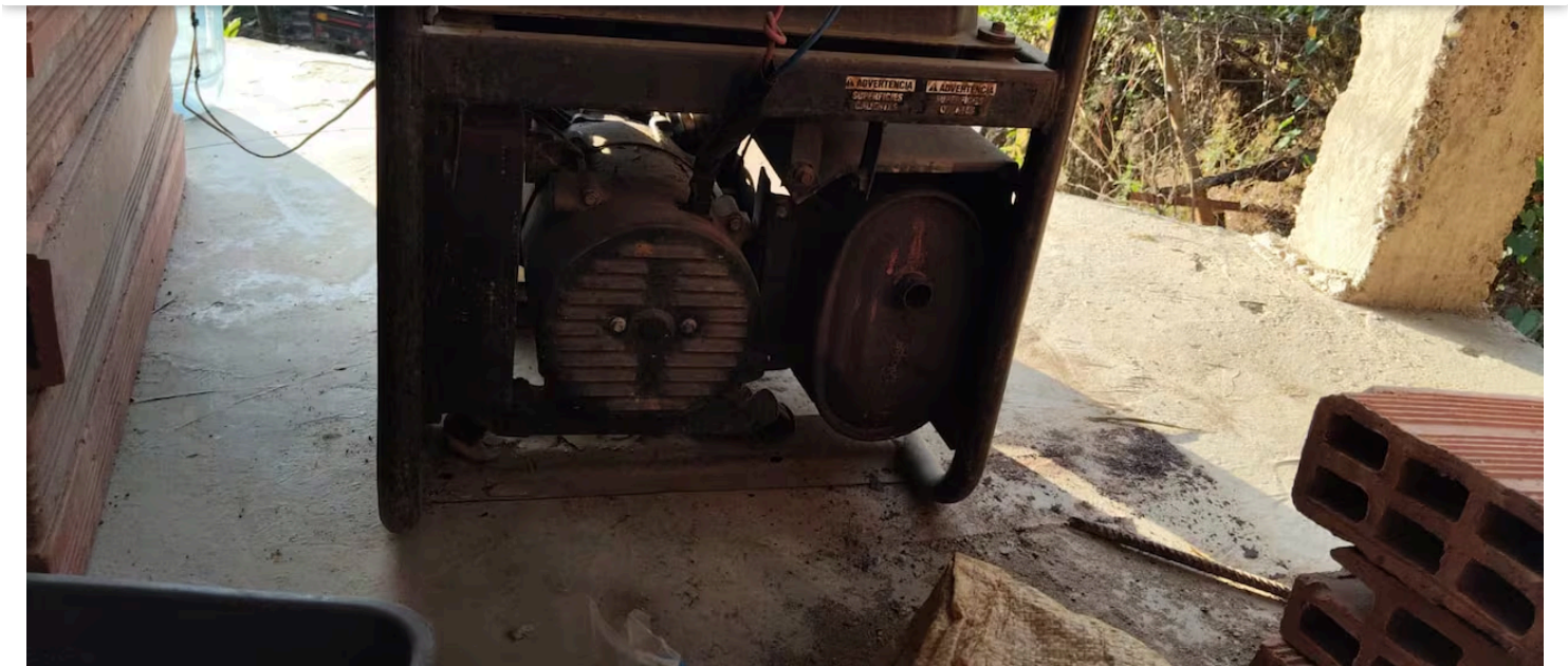
La empresa que presta el servicio indicó que estos largos cortes se debe, en parte, a las conexiones ilegales que existen en esta zona del norte del Cauca. | Foto: Suministrada
