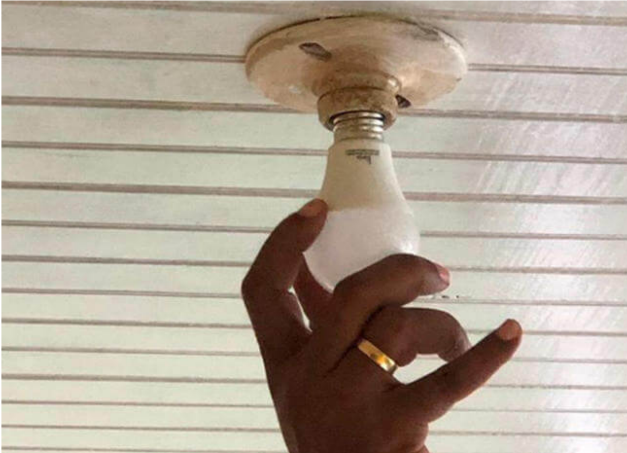
Servicio de energía // Foto: MinMinas
