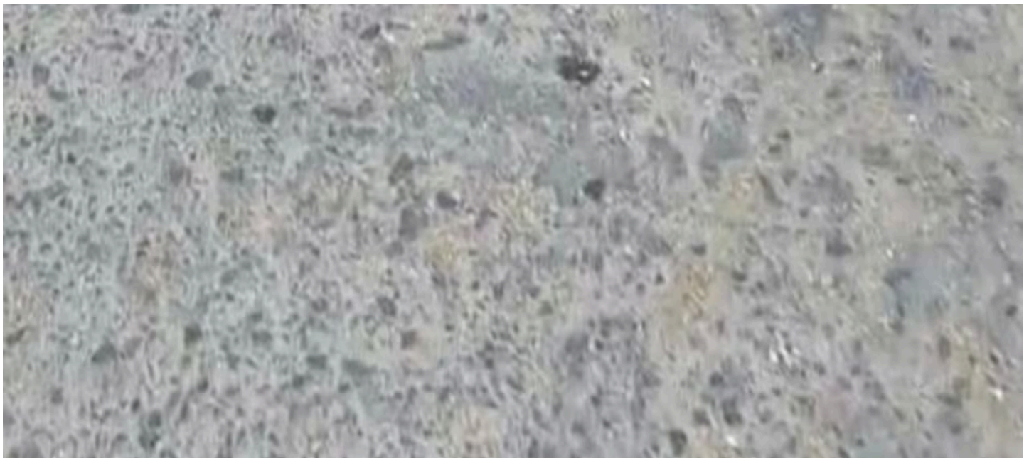
La Secretaría de Infraestructura explicó que las Calles 18N y 22N están dentro de los procesos de revisión técnica para futuras intervenciones. | Foto: Cortesía a El País
