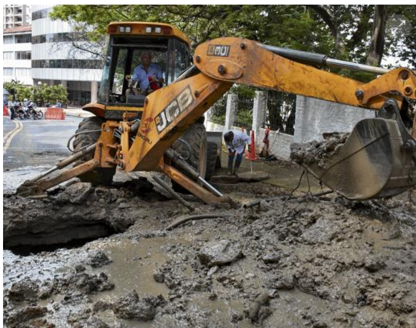
Operarios de Emcali excavaron para arreglar la tubería afectada y por ello se formó este enorme hueco en un sector de la Carrera 2 oeste. Se adelantan obras de alcantarillado. Raúl Palacios / El País
