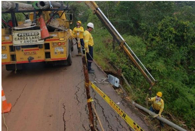
Hundimiento y caída de poste en vía La Buitrera, La Fonda y Villacarmelo
