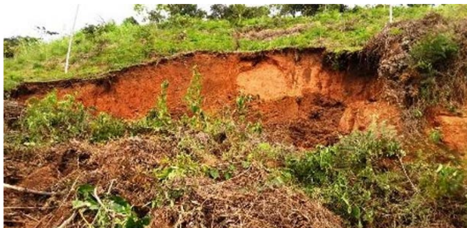
Deslizamientos en Florida Valle
