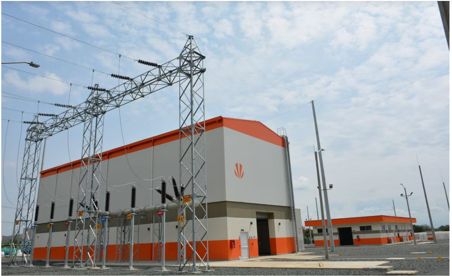
Esta es la primera subestación digital de energía en el Valle del Cauca y está ubicada en el municipio de Vijes. Foto: Celsia | Foto: Foto: Celsia
