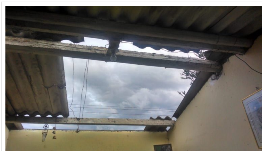
Los efectos de los fuertes vientos y borrasca fueron especialmente en los techos de las viviendas en la zona de Puelenje. / Suministrada –El Nuevo Liberal
