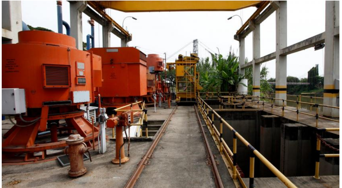
Estación de acueducto de Empresas Municipales de Cali (Emcali).
