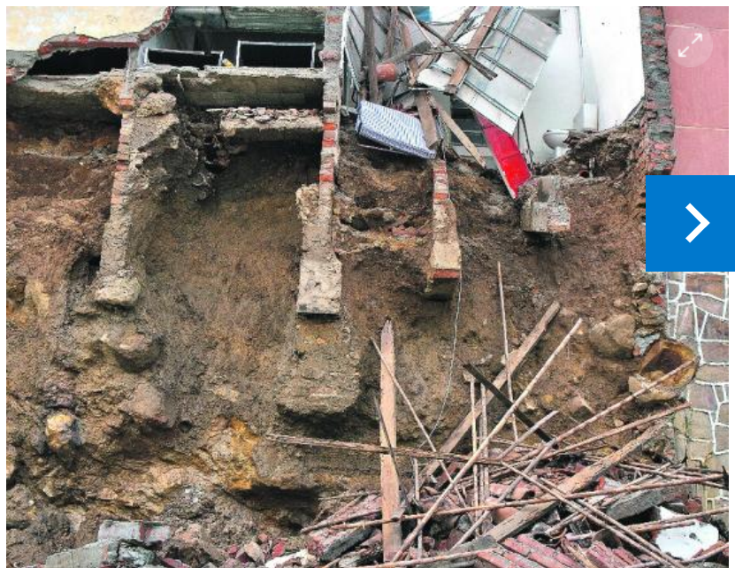
El muro cayó de una altura superior a los cinco metros de altura. Hoy, la edificación está acordonada y se restringe el paso. Raúl Palacios / El País
