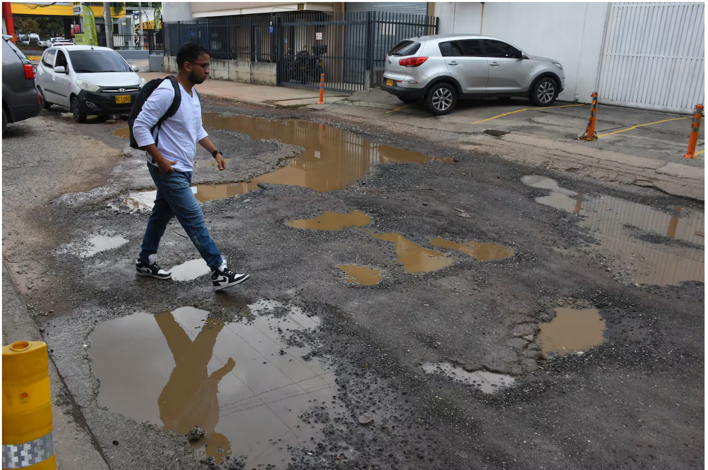
Vías en mal estado CRA 42 con calle 8A Los Cámbulos | Foto: Aymer Andrés Álvarez
