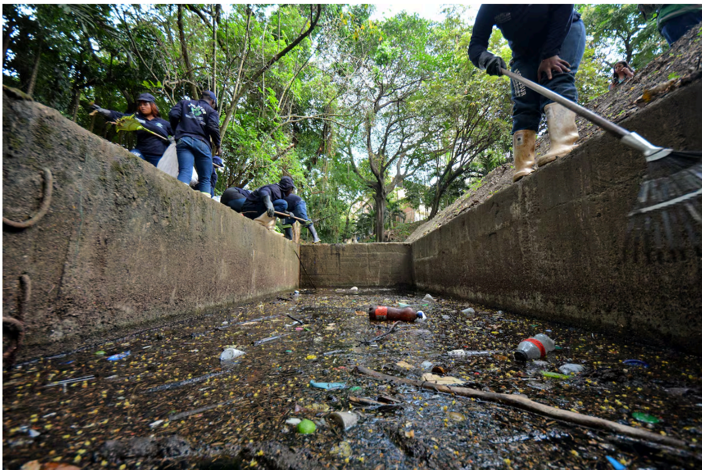
La limpieza de los sumideros y drenajes es esencial para garantizar su correcto funcionamiento. | Foto: Jorge Orozco
